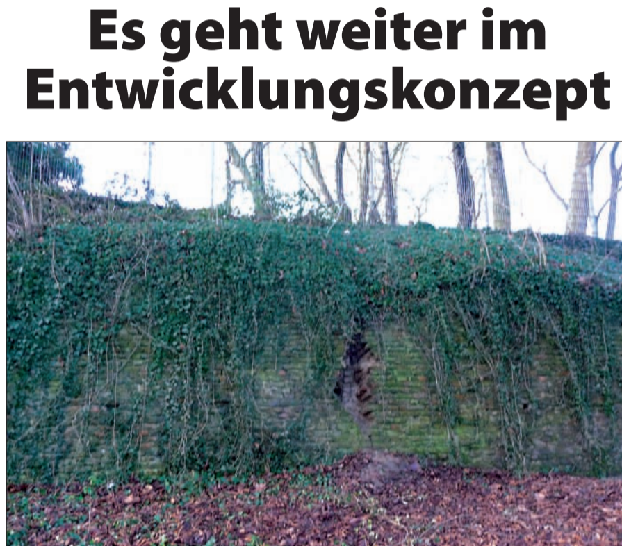
Teilansicht der erodierenden Festungseskarpe unterhalb der Kaiserswerther Grundschule. Die Sanierung soll im kommenden Jahr in Angriff genommen werden. Foto: H.S.
