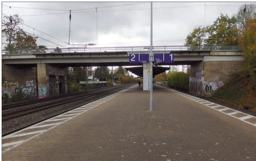
Der Brücke Angermunder Straße über die Bahntrasse sieht man ihr Alter und einfache Bauausführung an. Sie muss, wie die übrigen drei Angermunder Brücken, im Zuge des RRX-Ausbaus mit größerer Spannweite erneuert werden. Foto: H.S.
