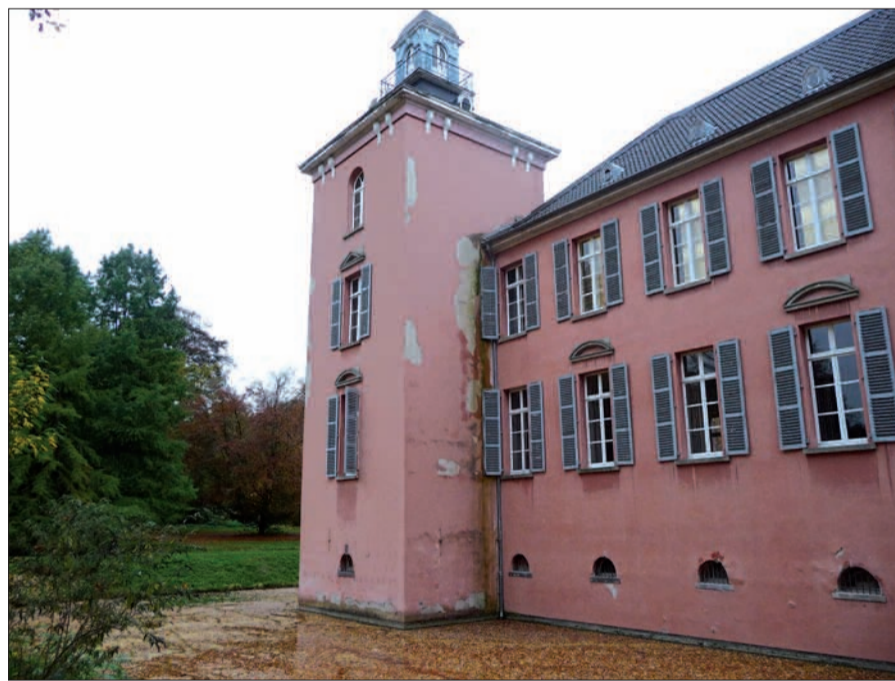
Sichtbarer Sanierungsbedarf am Südwestturm des Kalkumer Schlosses. Foto: H.S.
