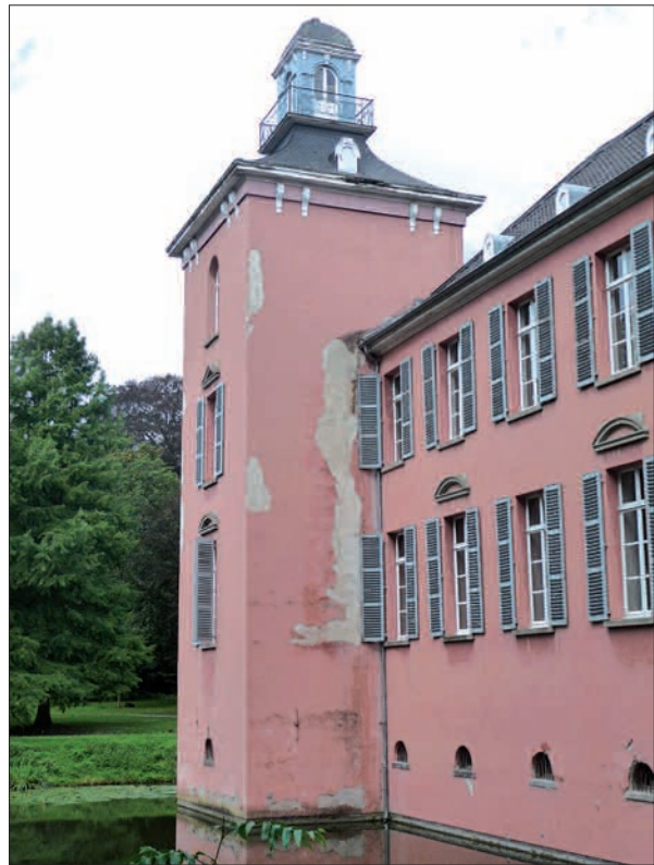
Am Südwestturm des Kalkumer Schlosses ist besonders anschaulich, wie seit Jahren das vom Dach direkt über die Fassade laufende Regenwasser Schäden verursacht. Foto: H.S.
