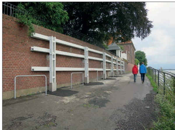
Stützgerüst an der Hochwasserschutzmauer in Kaiserswerth mit schadhaftem Asphalt. Foto: H.S.
