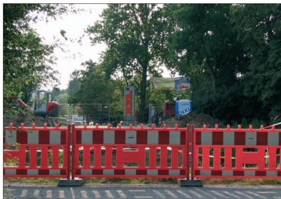
Jetzt sind sich Hüttenheimer und Huckinger sicher, die Brücke über den „Neuen Angerbach“ wird gebaut. Denn kann ein Bauzaun lügen? Das Brückenteil ist bereits fertig und wird Anfang August aus Norddeutschland angeliefert. Eine feierliche Eröffnung der Brücke wird es Anfang September geben. Warten (und wenn es bereits vier Jahre sind) lohnt sich eben doch. Bildtext & Foto: Horst Mosebach
