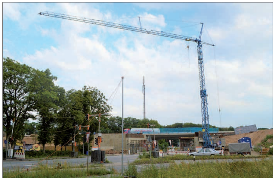
Noch bis zum Frühjahr 2021 wird die B288 zwischen Rahm und Serm zur A 524 umgebaut. In Richtung Krefeld ist die Anschlussstelle Huckingen noch bis zum 5. September gesperrt. Foto: sam
