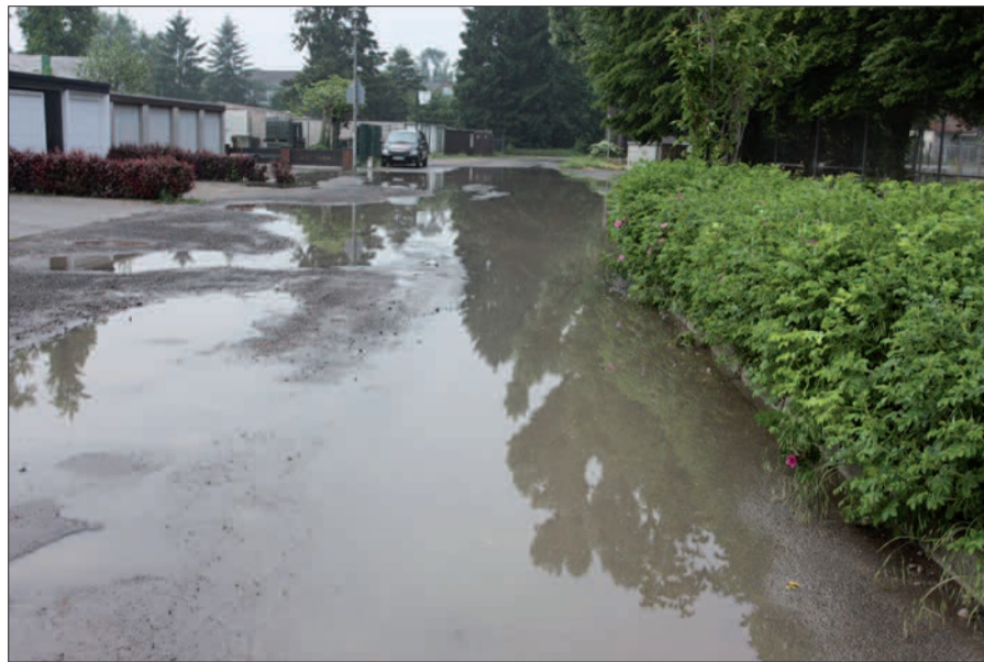
Schlaglöcher, nicht abfließendes Regenwasser – der Freiheitshagen ist in einem katastrophalen Zustand. Nun muss die Stadt aktiv werden. Text u. Foto: G.S.
