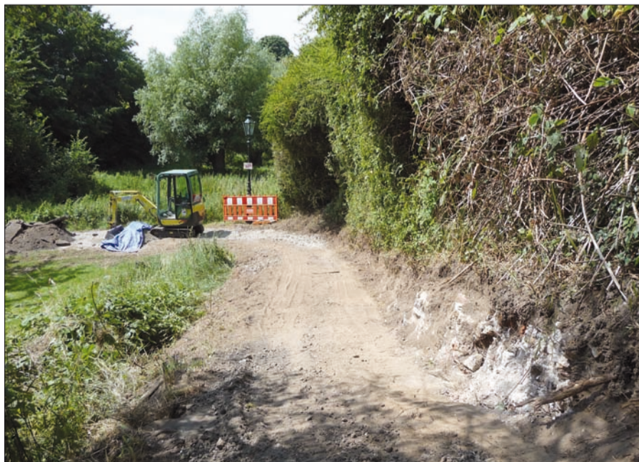
Natürlich wurden auch bei den vergleichsweise geringen Erdarbeiten am Fußweg über den Barbarosawall Mauerwerk der ehemaligen Bastionsverkleidung (Eskarpe) gefunden (rechts im Bild). Im Hintergrund der verwilderte Wallgraben, der zu einer Weiden- und Altobstwiese werden soll. Text u. Foto: H.S.
