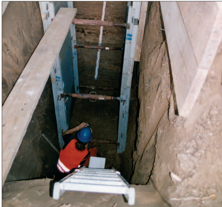
Über 5 m tiefe Gruben unterhalb des Schulhofes der Grundschule Flidnerstr. führen zu den Fundamenten der Festungsmauer, die ursprünglich aus dem 17. Jahrhundert stammt. Text und Foto: HS
