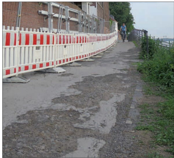
Der Asphalt an dieser Stelle der Rheinuferpromenade war so schadhaft, lange bevor die Baustelle eingerichtet wurde.
