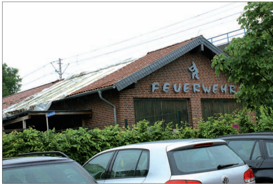
Ein großes Loch hat das Feuer ins Dach des Feuerwehrgerätehauses in Huckingen gebrannt. Alle dachten zunächst an einen bösen Scherz. Foto: sam
