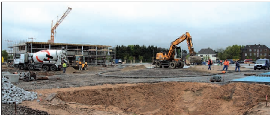
Dennoch gehen die Arbeiten mit unverminderter Intensität weiter, der angedachte Termin zur Fertigstellung im Herbst wird bei dieser Baugeschwindigkeit wohl problemlos eingehalten werden können.
