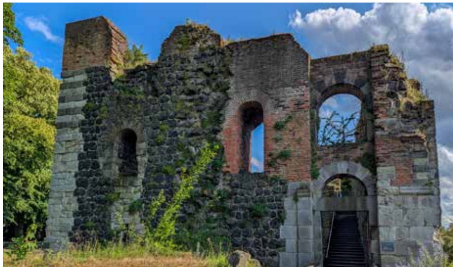
Die massiven Tuffsteinmauern der Kaiserpfalz Kaiserswerth gehören zu den größten erhaltenen Pfalzbauten Deutschlands. Foto: ah
