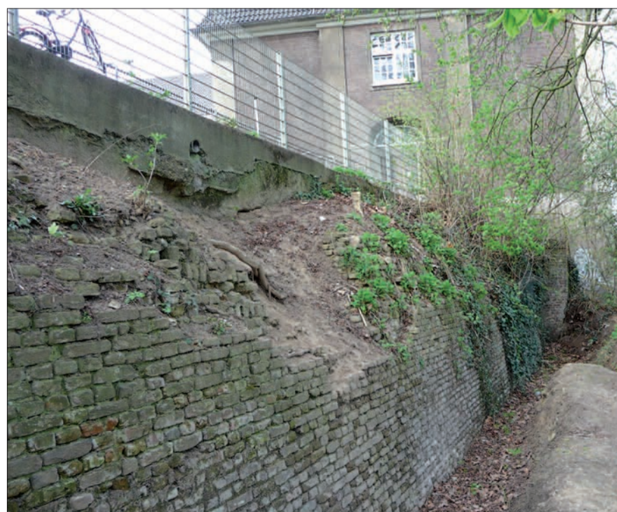
Der Rest der ehemaligen Ziegelverblendung der denkmalgeschützten Festungswälle um Kaiserswerth verfällt mehr und mehr. Foto: H.S.
