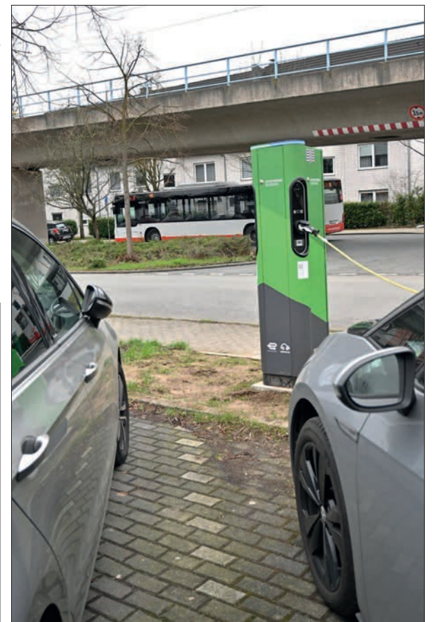
Eigentlich dürfen an dieser neuen Ladesäule in Huckingen in der Nähe der Helios Klinik St. Anna nur E-Autos während des Ladevorgangs abgestellt sein. Ein Schild soll bald Klarheit schaffen. Foto: sam
