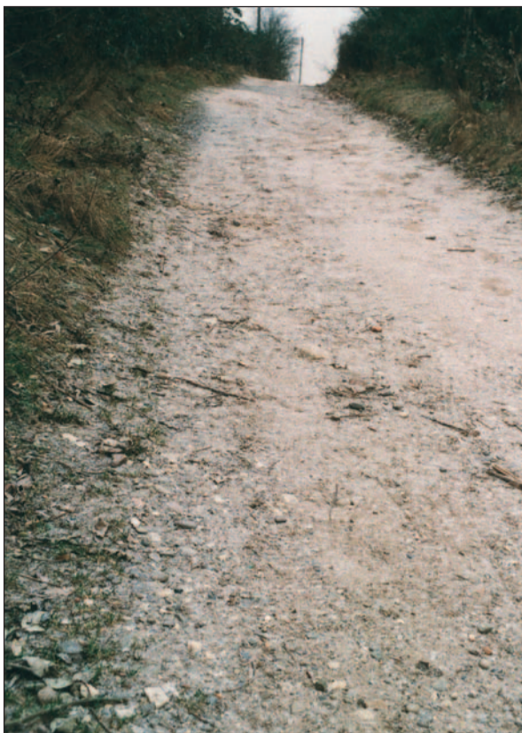
Durch Regen ausgewaschene Erosionsrinnen in der Alten Kalkumer Strasse Text und Foto: HS
