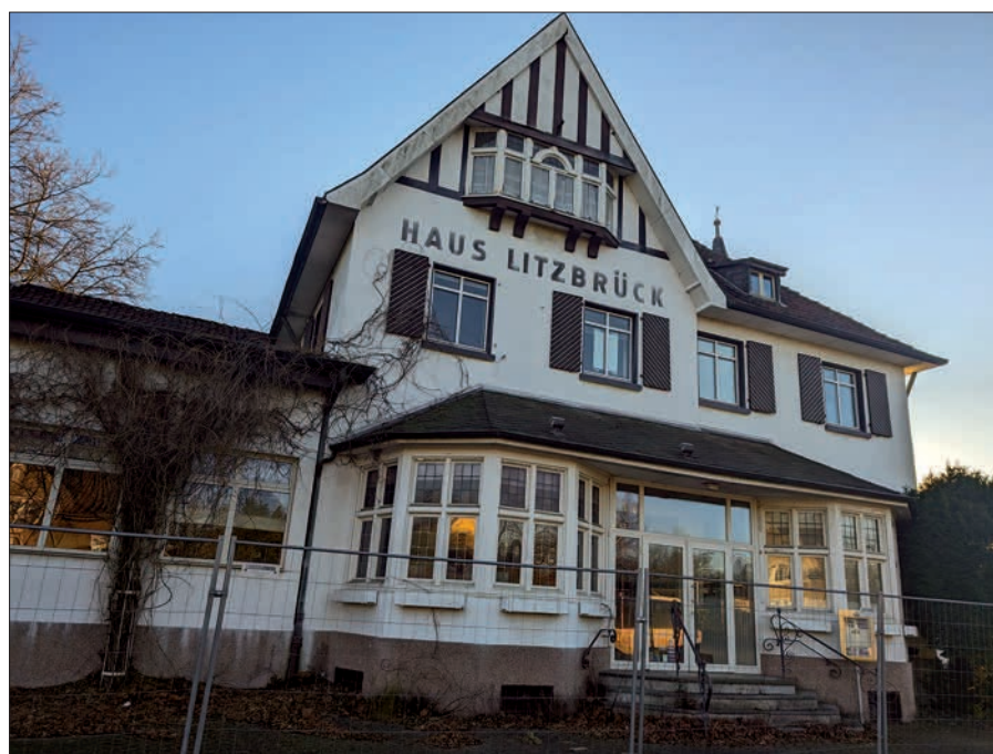
Einst der schönste Treffpunkt für alle Familien aus Angermund und dem Umland, verfällt Haus Litzbrück immer mehr. Vielleicht findet sich doch ein Investor, der dem Haus zu altem Glanz verhilft. Foto: GS
